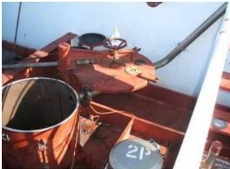
(*Bild: Rör utan dränering*)
