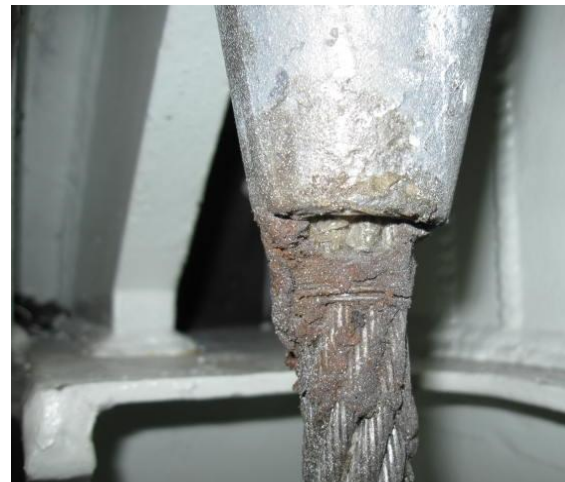
Vajer börjat krypa ut ur ändbeslag (närbild)
