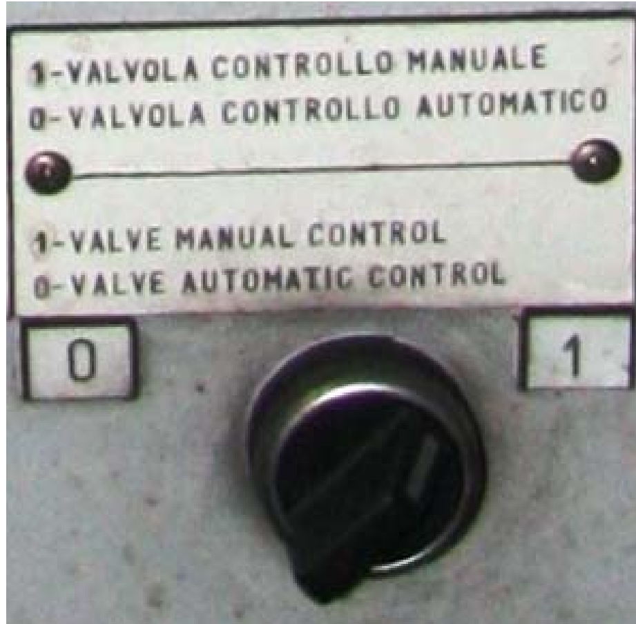
Bild 2: Strömställare till drencherpump som stod i fel läge
