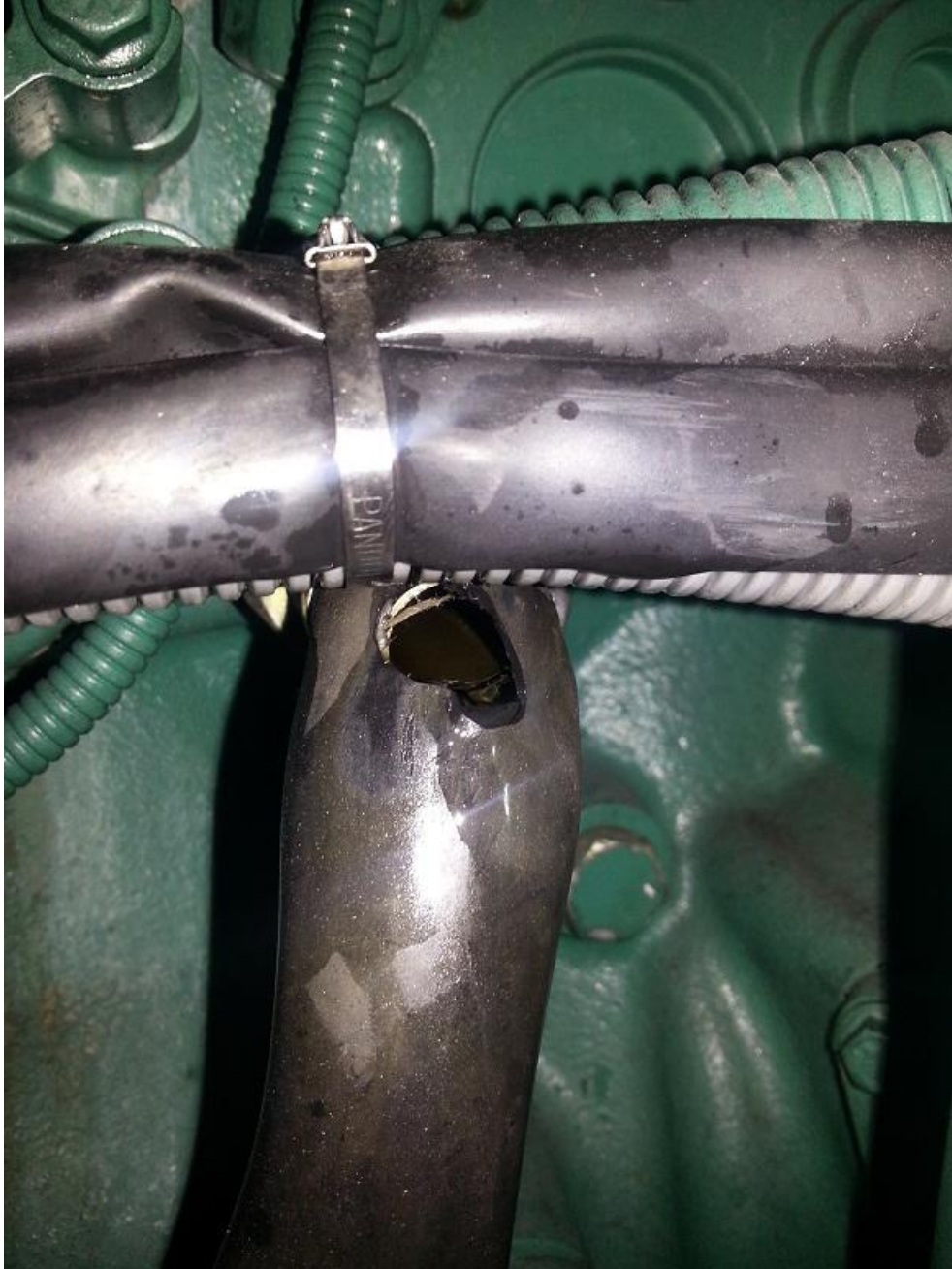
Bild 1: Hål i kylslang mellan motor och motorvärmare
