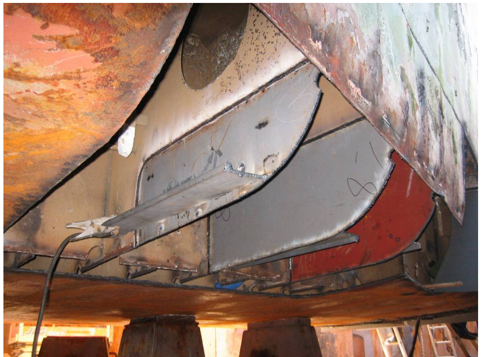
Bild. Berört skadeområde i 1:an styrbords ballasttank
