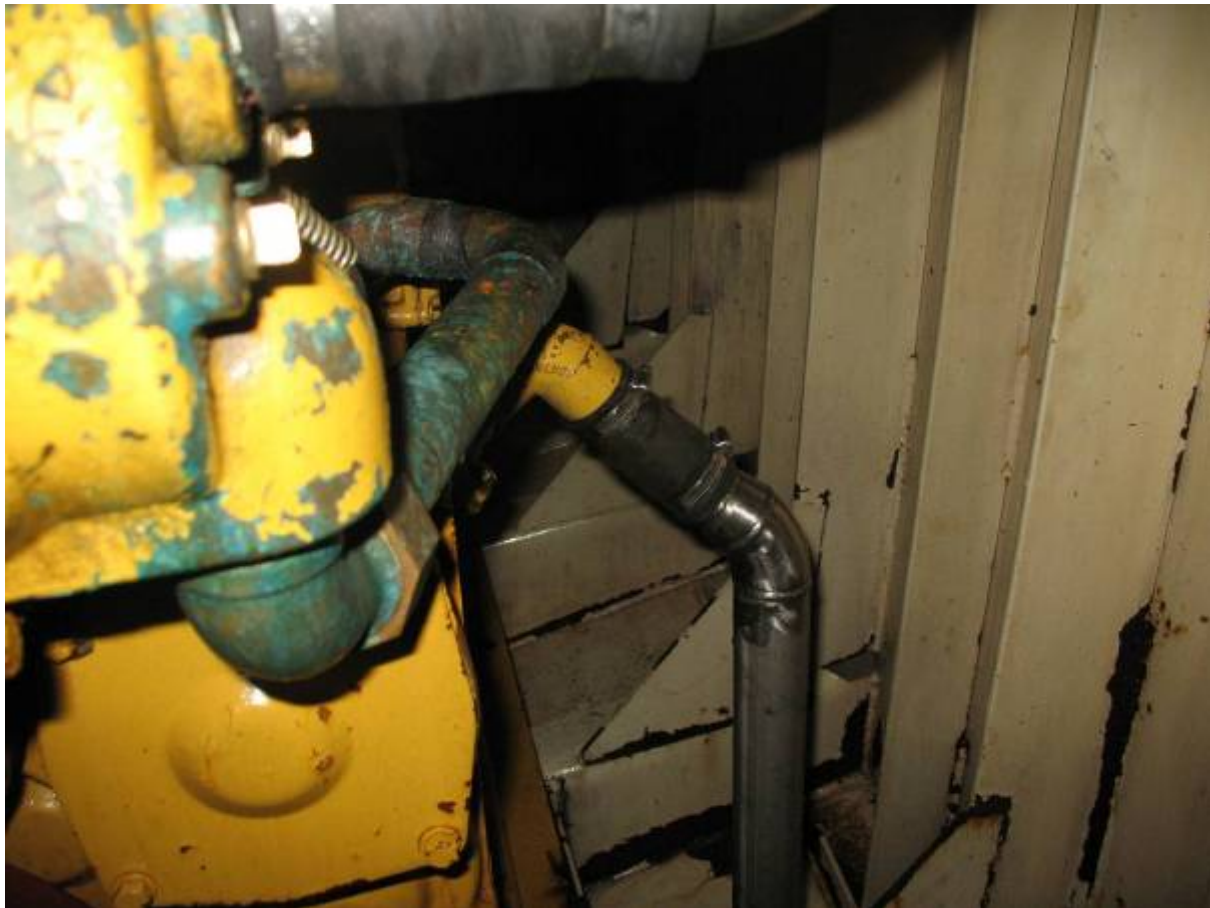
Den aktuella kylvattenanslutningen.
