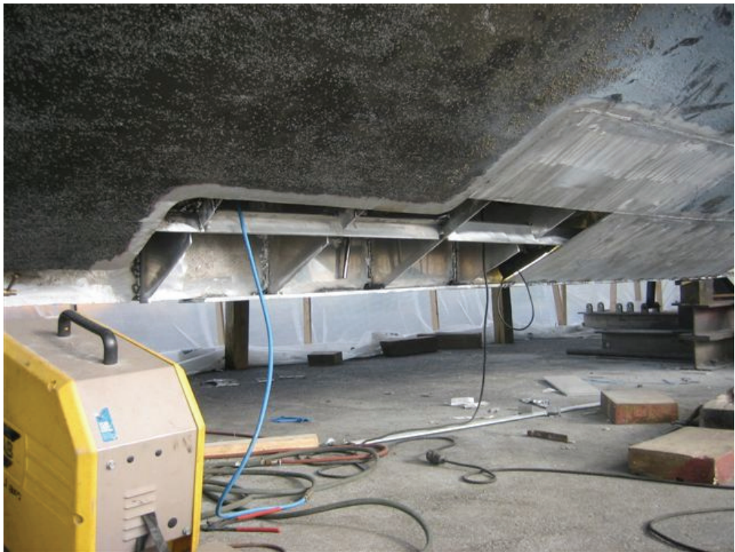
Bild En av skadorna
