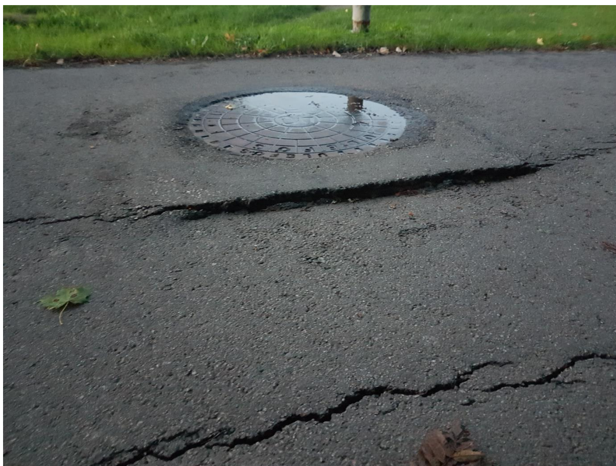
Figur 3 Längsgående kant hos en nylagd cykelbana som skadats av belastning av tungt fordon i angränsning till en brunn, foto: Leif Sjögren.
