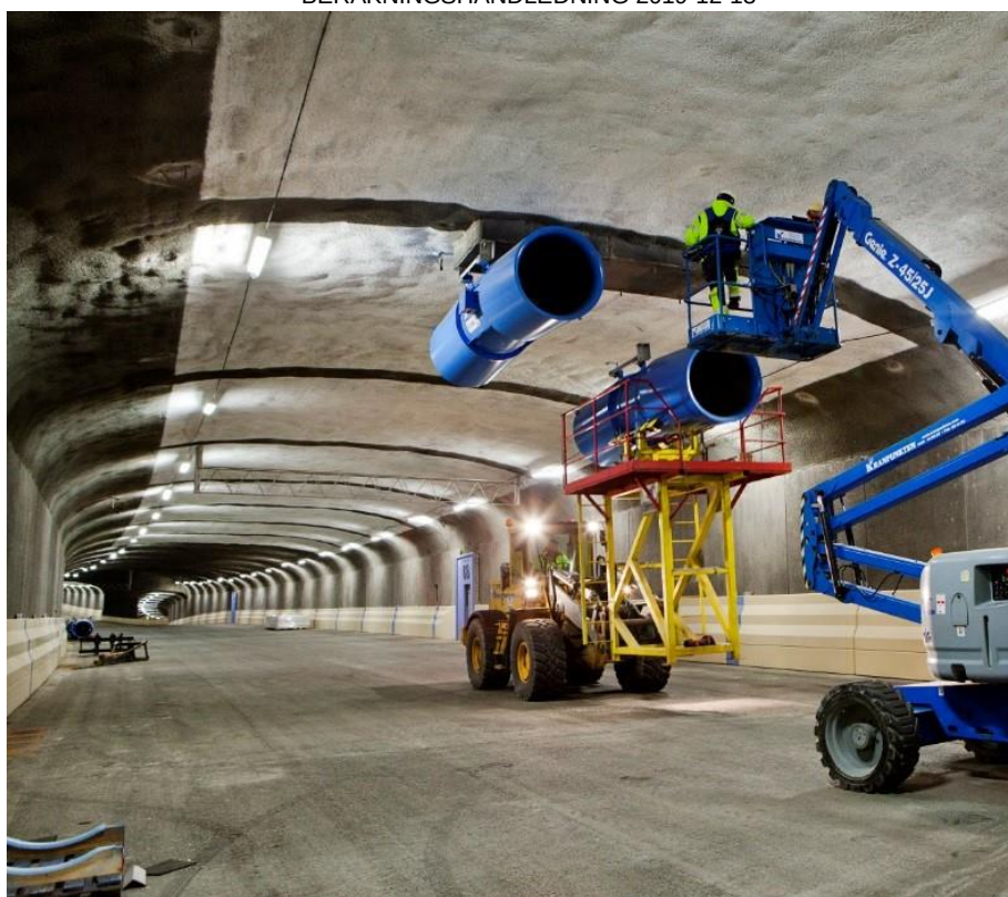
Impulsfläktar i Norra länken. Foto Michael Ullén.
