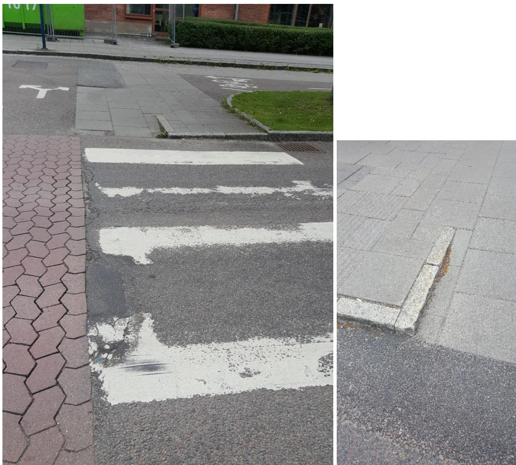
Figur 16. Exempel på övergångsställe med behov av underhåll och detaljbild av trottoarkant med rätvinklig riktningsvisning. Bild: A. Arvidsson
