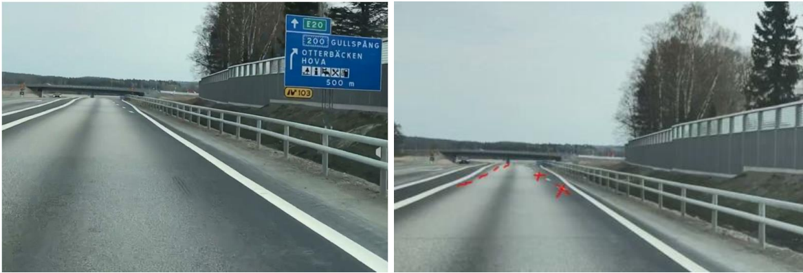
Figur 6 Övergång från ett till två körfält norrgående riktning. Felaktig (provisorisk) målning får fordonsförarna att tro att detta är avfarten mot Hova. Trafiksäkerhetsgranskarens anvisningar med rött i bild till höger. Bilder från trafiksäkerhetsgranskarens rapport (Ramböll).
