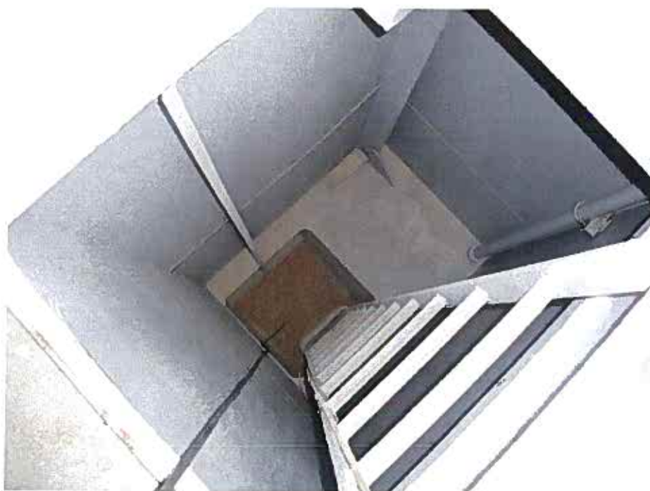
Bild 2 Trapphus till lastrum med vete, synligt i botten av trapphuset. Här uppmättes 300 ppm fosfin.
